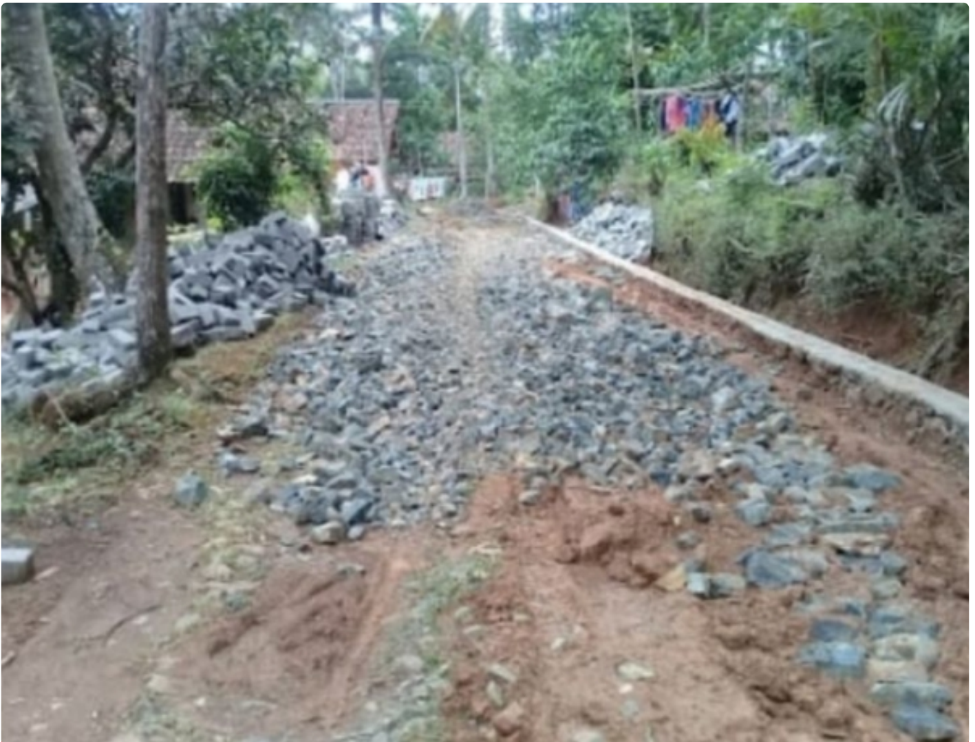
Proyek PISEW di Kecamatan Cimanggu Diduga Bermasalah
